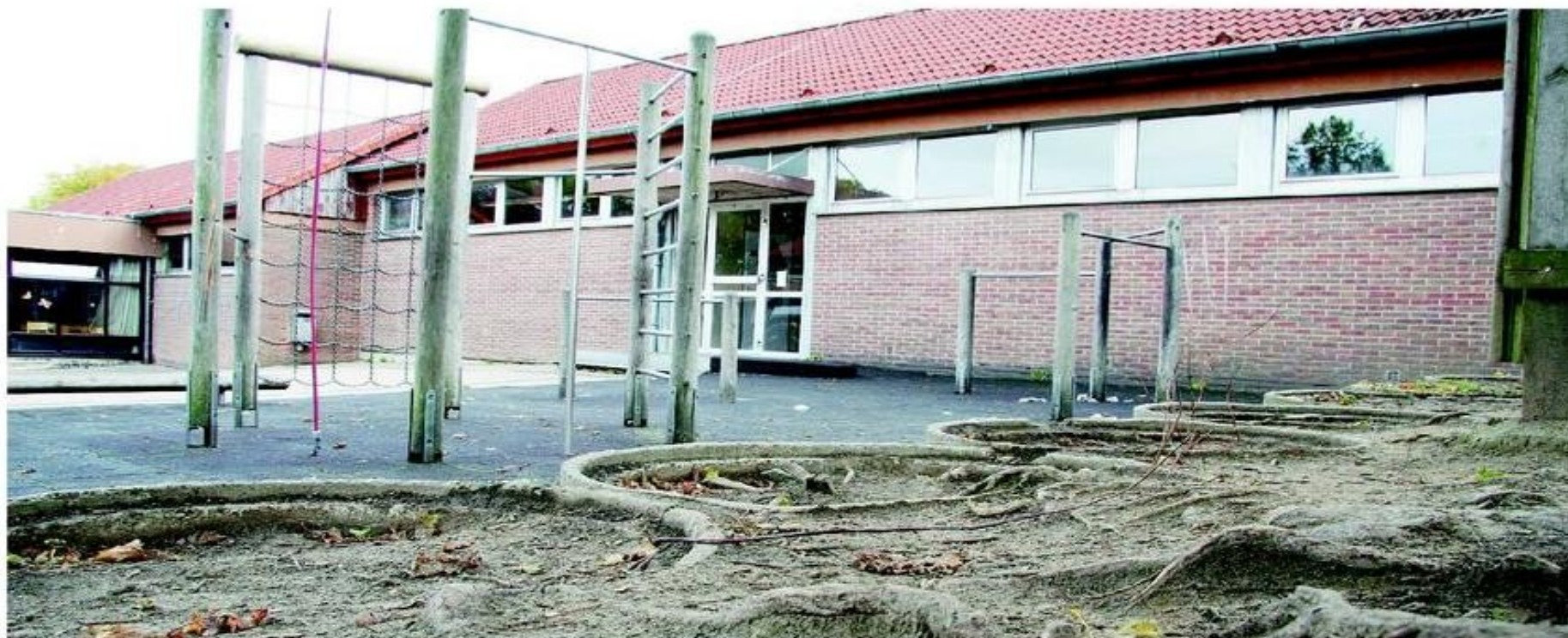
Nach den Sommerferien verwaist: Die mit Schadstoffen belasteten Pavillons an der Grundschule Brake haben laut Ratsbeschluss ausgedient.
